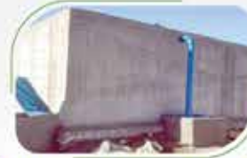
(آغاز عملیات اجرایی) مخزن تعدیل آب خیابان معلم و مخزن ذخیره پساب تپه اعلاثیر
