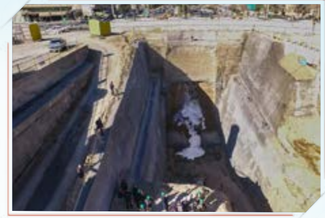
اتمام عملیات حفاری مکانیزه و خروج دستگاه TBM خط یک متروی قم - دی ۹۵
