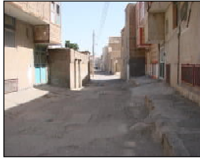
تصویر شماره 7-28: عدم اجرای صحیح کف سازی و فرسودگی بافت کف سازی ها
