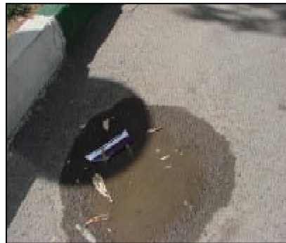
تصویر شماره 7-26: کفسازی نامناسب معابر محلی و آب‌گرفتگی معابر
