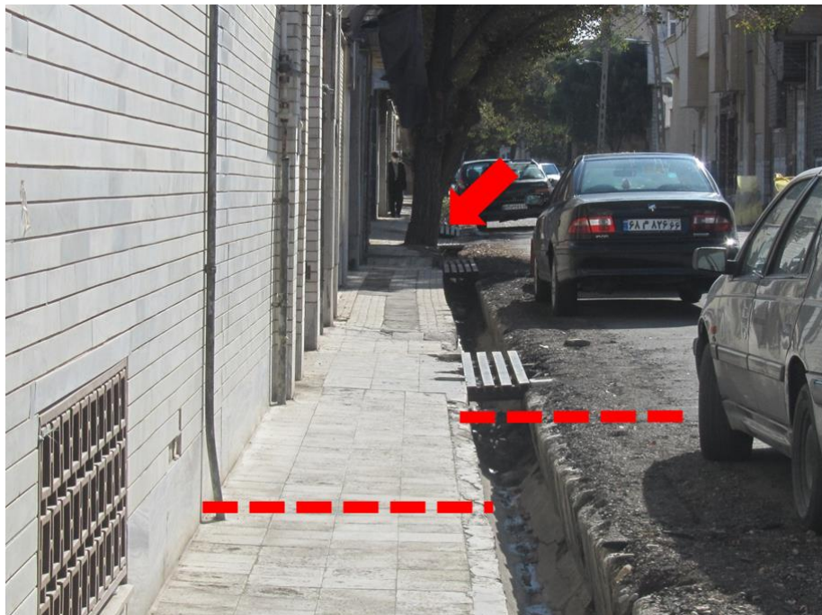
شکل ۳-۶ نمونه ای از مشکل ایمنی نوع ۶- نامناسب بودن کف سازی و اجزای مسیرهای پیاده و سواره
